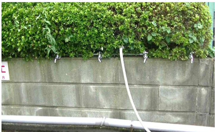
写真5：臨時給水栓 (左側=防火倉庫側)
